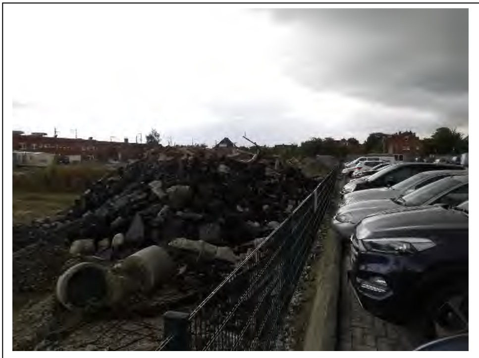
Foto 4: Das westlich der Baugrube befindliche Bauschutthaufwerk wurde bisher nicht abgefahren (August 2018).
